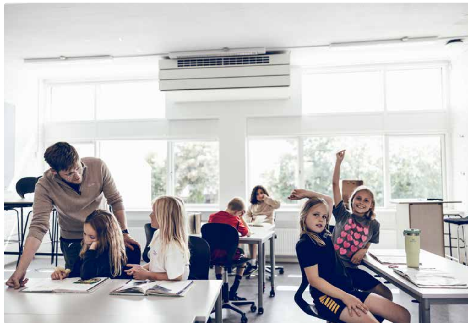
Et godt indeklima øger velværet, indlæringsevnen og reducerer sygefraværet. Men ventilationsløsninger mangler fortsat i utallige skoler og institutioner landet over. Foto: Airmaster
