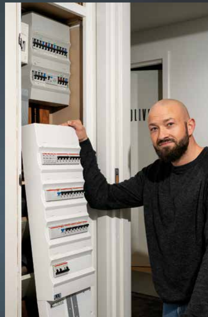
Lynskader. Et lyn sendte en kraftig overspænding gennem eltavlen i Carsten Helmo Enemarks hus og ødelagde elektronik og installationer for mange tusinde kroner. I den nye eltavle skal ABB SPD-relæer (øverst til venstre) fremover forhindre lignende situationer.
