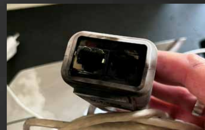
Brændt af. Sådan så kabler og samledåser ud, efter et lyn sendte en kraftig overspænding gennem eltavlen i Carsten Helmo Enemarks hus og ødelagde elektronik og installationer for mange tusinde kroner.
