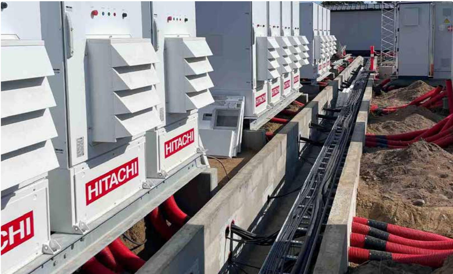
^ Der er behov for snesevis af store batterianlæg i en fremtid, hvor stadig mere strøm kommer fra grønne kilder som sol og vind.
