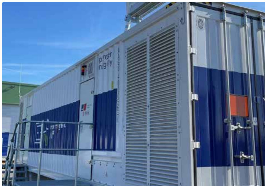
EWII's batterianlæg ved Lindø Offshore Renewables Center på Fyn leverer systemydelse til Energinet, der er med til at stabilisere elnettet. Foto: EWII
