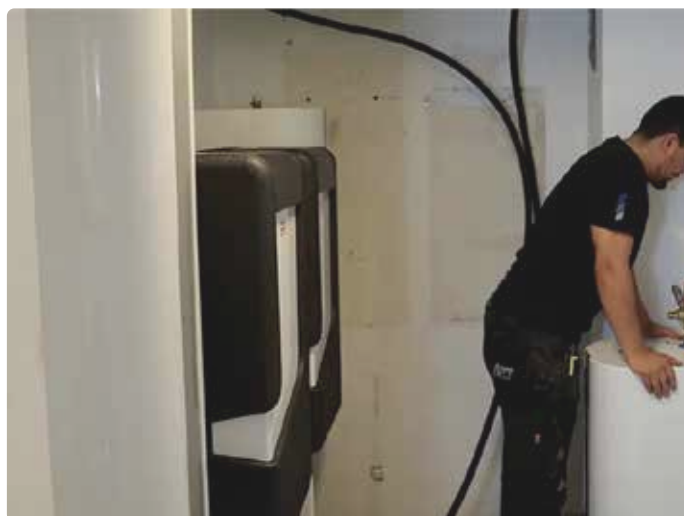
Den nye installation med 2 x METRO Delta, bufferbeholder og varmtvandsbeholder afløser den gamle gasfyр-installation.
